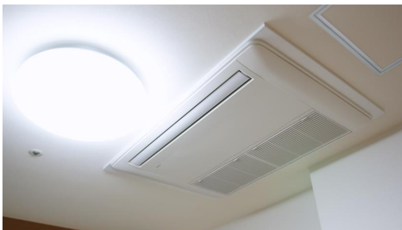
明るさ調整機能付LEDライト、エアコン交換済み
